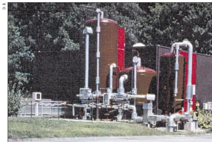
D.R. Station d'épuration biologique de l'entreprise Solectron près de Bordeaux.
